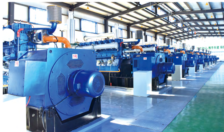
七台河矿业公司三和分公司蓝天瓦斯发电站
