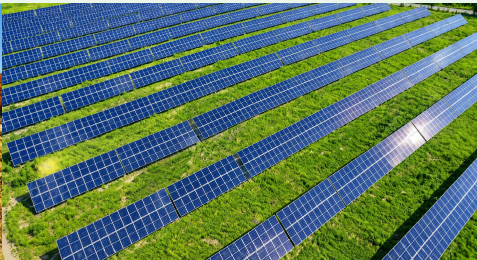
矿区太阳能光伏电站
